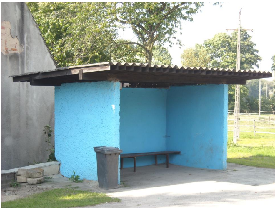
Fot. 5. Płyty azbestowe na wlocie przystanku, podobnie jak odnotowano to w przypadku miejscowości Brody-Malina.
