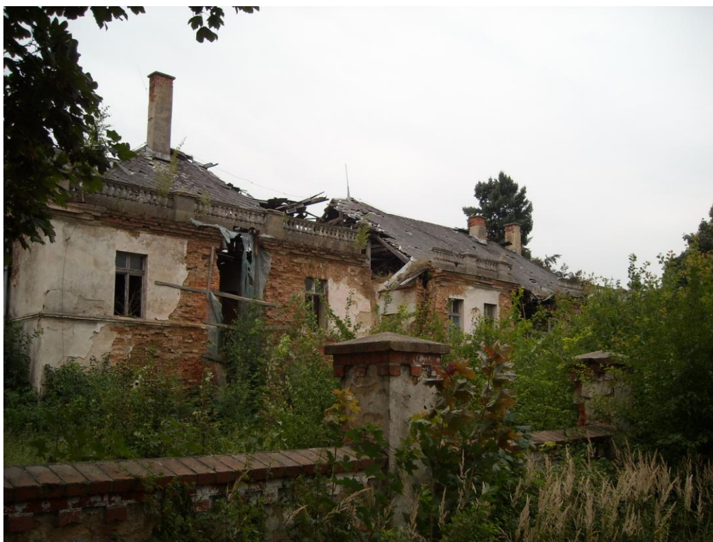
Fot. 4. Obiekt o pilnym stopniu demontażu azbestu.
