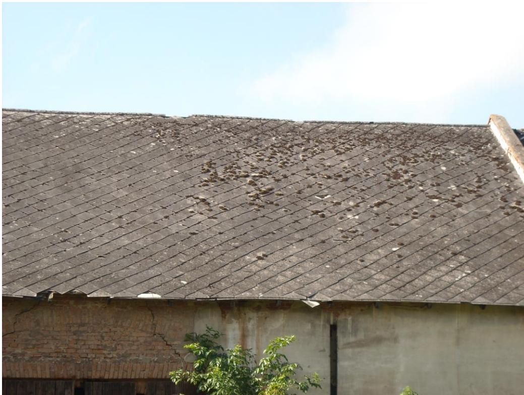
Fot. 3. Uszkodzone płyty azbestowe - typu karo.
