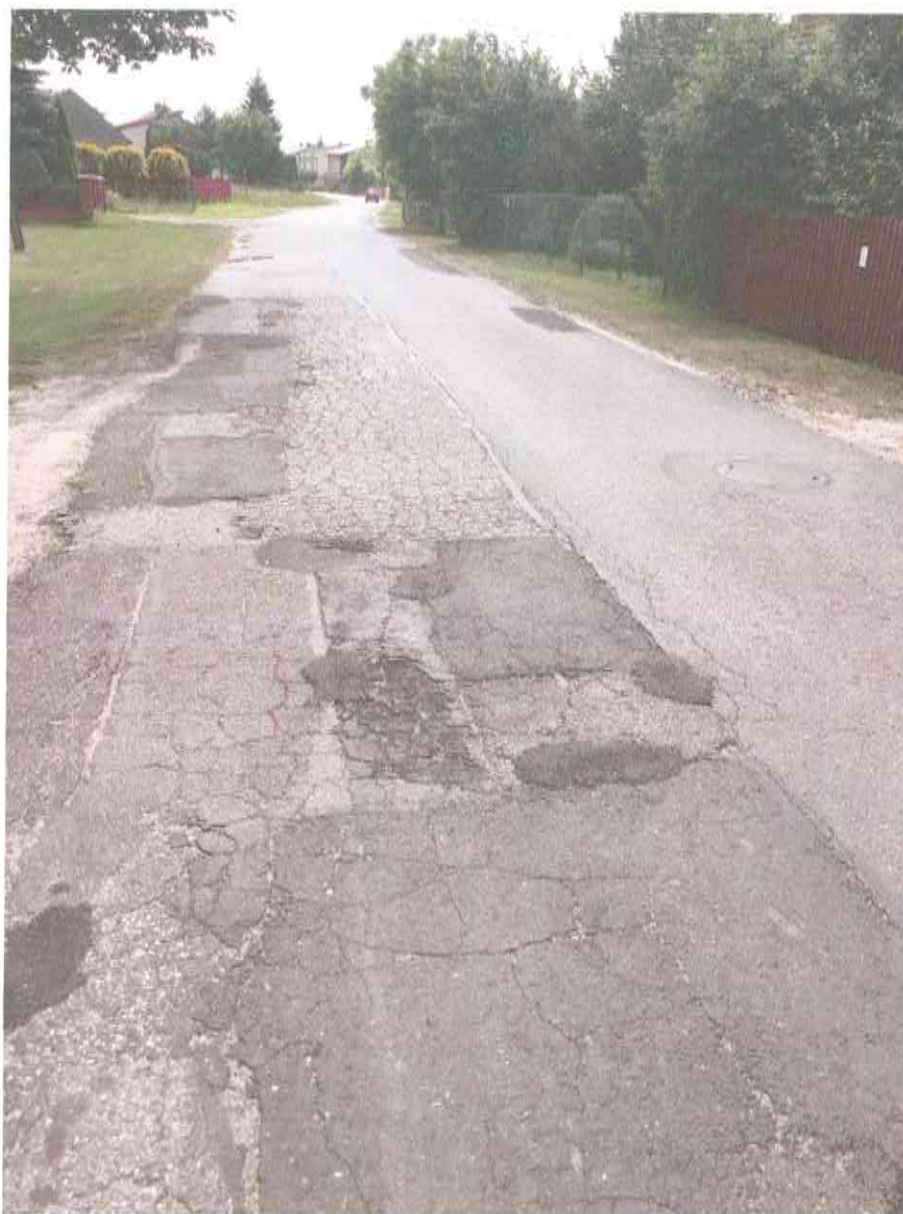
Fot. 2 Stan nawierzchni
