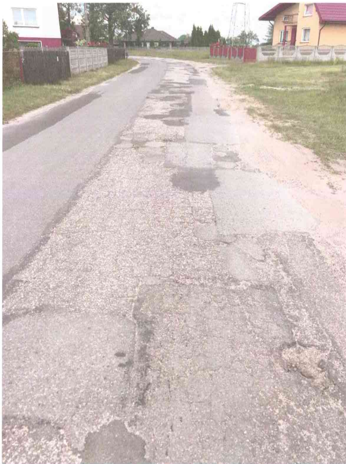
Fot. 3 Stan nawierzchni
