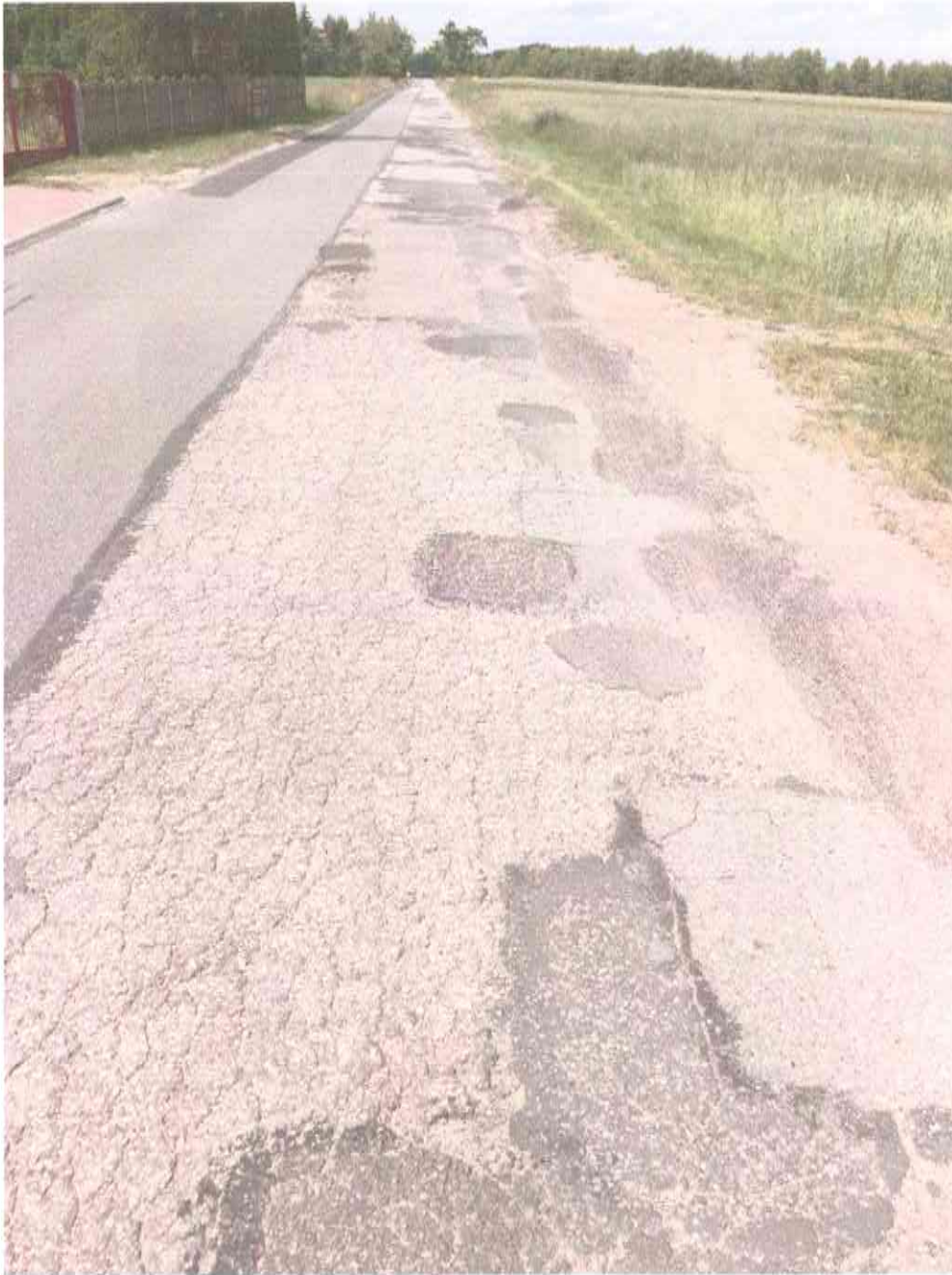
Fot. 4 Stan nawierzchni
