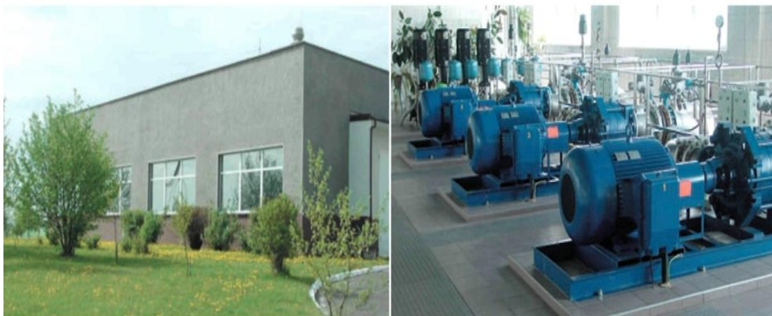
Fot. 6. Stacja Ujęcia Wody (SUW) „Łobodno”
